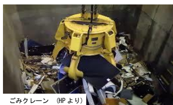
ごみクレーン(HPより)
